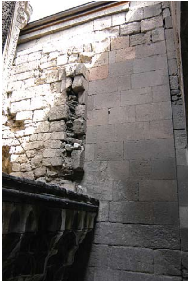
Hunat Hatun Türbesi, medrese duvarında eski yapının bakiye izleri
