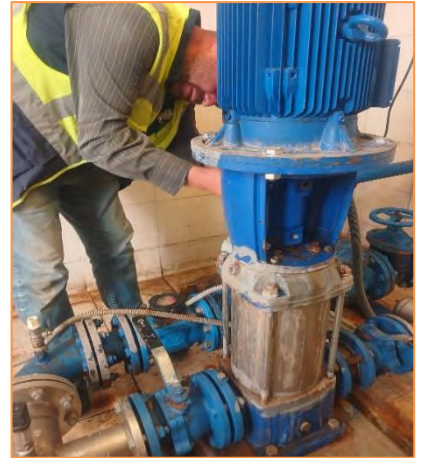
Sulama Tesisatı Arızaları
