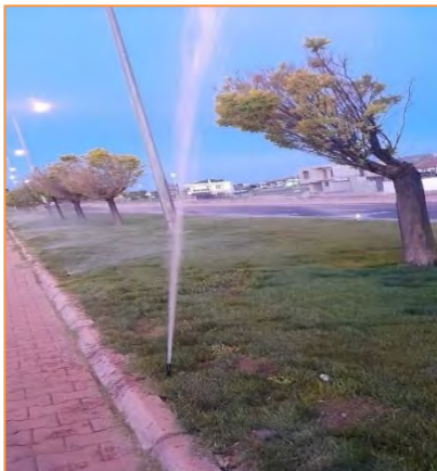
Sulama Tesisatı Arızaları
