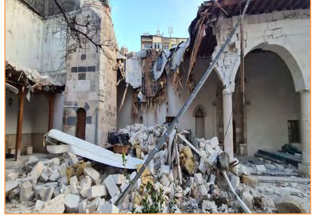
Deprem Sonrası Boğazkesen Camii
