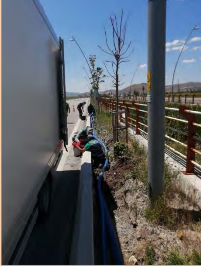
Bekir Yıldız Bulvarı Tesisat
